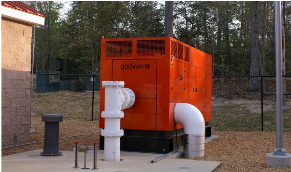
Slika 2. Godwin diesel crpka s Dri-Prime® sistemom, fiksno ugrađena u javnoj kanalizaciji
